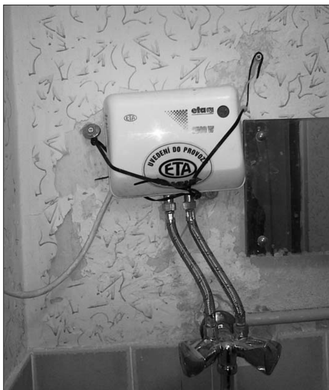
I takhle může vypadat instalace průtokového ohřivače v šatně jisté venkovské pošty. Vyfoceno svazovým inspektorem BOZP.
